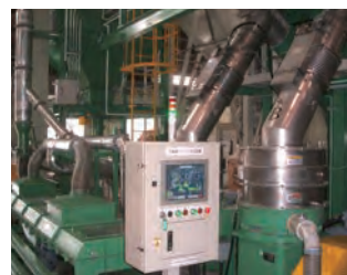
使用済み冷蔵庫の断熱材 (廃ウレタン) 固形燃料化装置の外観
