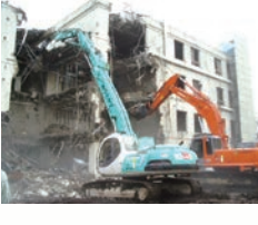
アスベスト調査・除去工事、 建築物・施設解体撤去工事
