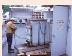
PCB機器の搬出・運搬・処理 搬出不可機器に係るPCB分析 設置場所におけるPCB簡易分析
