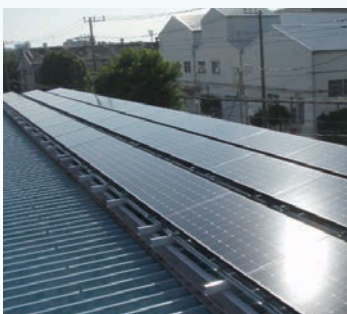
#811建屋屋上に設置された太陽光発電システム
