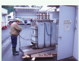
PCB機器の搬出・運搬・処理 搬出不可機器に係るPCB分析 設置場所におけるPCB簡易分析
