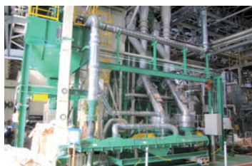
使用済み冷蔵庫の断熱材(廃ウレタン) 固形燃料化装置の外観
