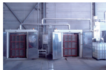
汚泥乾燥機の外観
