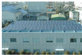
入舟事業所設置の20kw 太陽光発電システム
