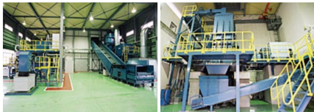
2008年10月に本格稼働した大型破碎選別処理プラント
